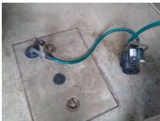
Slika 8: Prečrpavanje vode iz spodnjega v zgornji rezervoar
