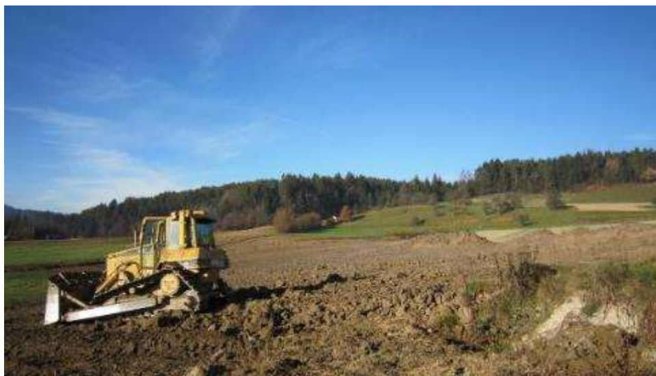
Slika 14: Območje sanacije vertikalne razpoke obsežnega dela posednega terena
